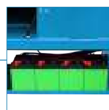
Гелевые необслуживаемые АКБ (в отсеке)
